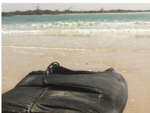
Photo 6 : Protection par digue avec sacs de sable détruits après une surcote. Sambou D. 01/2019
